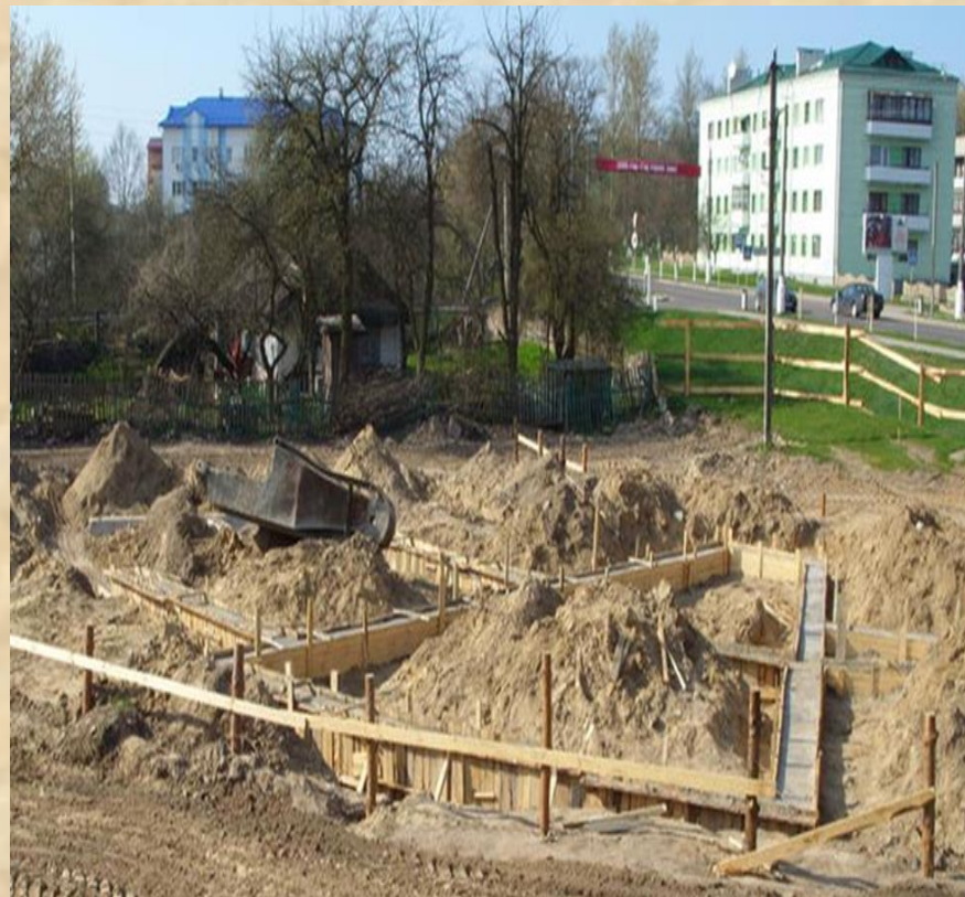
ул. Брестская, место, где были обнаружены гранитные плиты со старого кладбища «Кворес».
